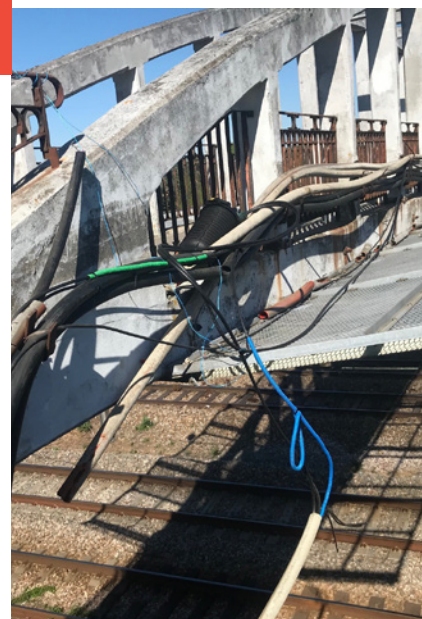
Câbles sectionnés sur la passerelle
